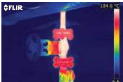
В ходе осмотра было выявлено порядка 150 неисправностей, которые были подробно описаны с использованием высокоточных данных, полученных благодаря камере FLIR
