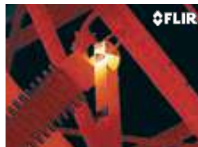
Неправильно выполненное соединение
