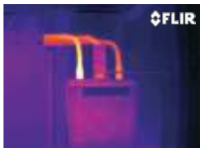
Неисправное соединение и внутреннее повреждение
