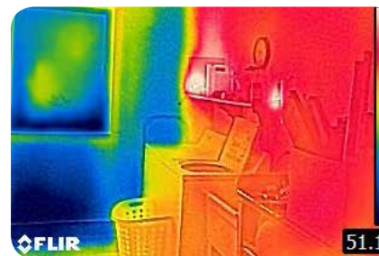
C2 ПЛОХО ИЗОЛИРОВАННАЯ СТЕНА
