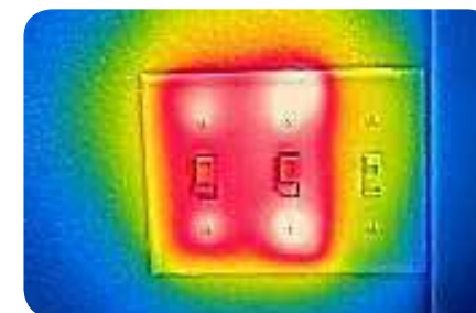
C2 ПЕРЕГРЕВ ВЫКЛЮЧАТЕЛЯ
