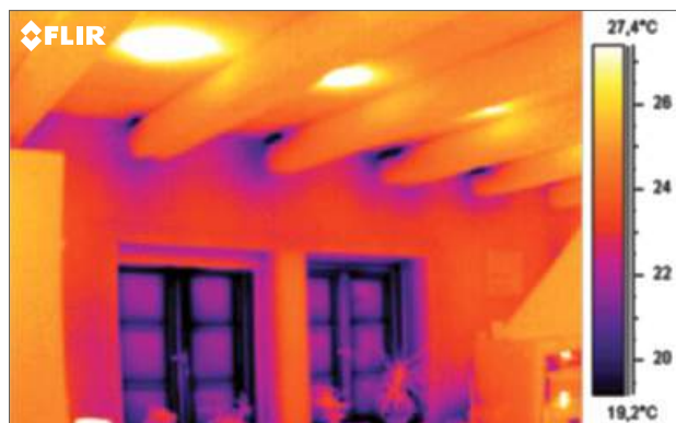
На термическом изображении видны тепловые мосты между балками перекрытия и смежными стенами.
