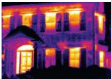
Рис. 5-49. Области с отсутствующей теплоизоляцией проявляются в виде теплых участков на внешних стенах здания в холодную погоду.
