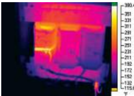
Рис. 5-58. Тепловое изображение трехфазного сухого трансформатора показывает, что основной вывод на левой фазе имеет ненормальный нагрев.
