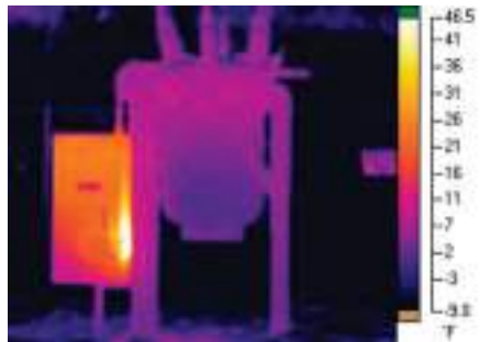
Рис. 5-47. Тепловидение можно использовать для того, чтобы зафиксировать, нормально ли работает нагреватель внутри шкафа управления для предотвращения конденсации.
