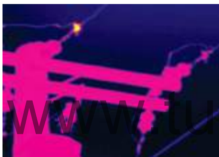
Рис. 5-16. Соединение с высоким сопротивлением на переключке (возможно вследствие коррозии) может иметь значительные последствия при дальнейшем увеличении нагрузки.
