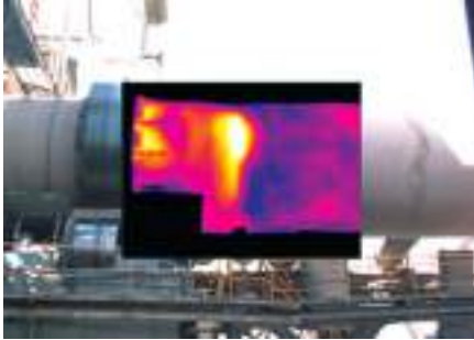
Рис. 5-9. Тепловидение можно использовать для контроля состояния футеровки во времени и выявлять проблемные зоны в цементных печах и другом промышленном оборудовании.
