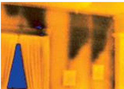
Рис. 5-69. Плохо установленная незафиксированная теплоизоляция в существующей полости стены может слезаться и стать неэффективной.
