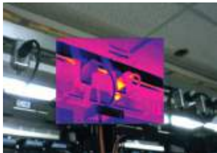
Рис. 5-81. Правая розетка серверной стойки имеет тепловой рисунок, который указывает либо на соединение с высоким сопротивлением, либо на проблемы с проводкой.
