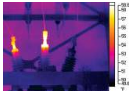
Рис. 5-59. Два из шести вводов маслонаполненного разъединителя имеют ненормальный нагрев и говорят о состоянии, которое может привести к серьезным финансовым последствиям, если бы его не выявили и не отремонтировали.
