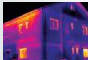
Выявление энергетических потерь в зданиях: Моментальное обнаружение и фиксация тепловых мостиков на фасадах или в ограждающих конструкциях зданий
