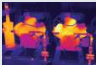
Экономия времени и ресурсов: Быстрое выявление температурных аномалий и утечек в трубопроводах
